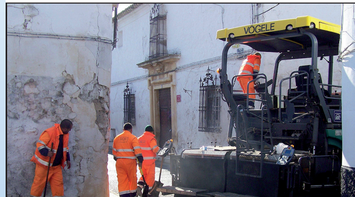
Se han asfaltado y reasfaltado calles, incluyendo la renovación de redes de agua potable y alcantarillado
